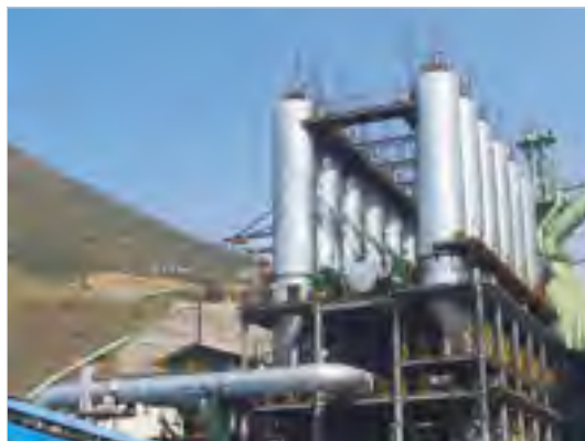
▲ 攀枝花钢铁有限公司新三号高炉余压发电装置
