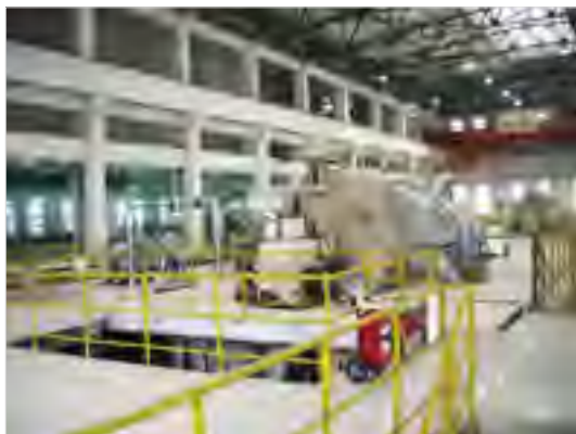
▲ 鞍钢鲅鱼圈钢铁基地煤气炉发电项目2号发电机组成功实现并网发电
